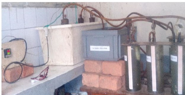
Photo 1 : Montage et disposition des matériels au CNRIT
